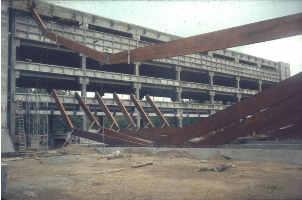
19. kép. Spartacus Uszoda építése. Budapest X. Kőér utca. Építész: Sylvester Ádám, statikus Steinhausz Tibor. A ragasztott fa gerendákból álló rúdlánc főtartó helyére emelése. Balra a masszív többszintes épületszárny, mely az áthidalás lehorgonyzását is biztosítja. MIEA 22601_22805_0004
