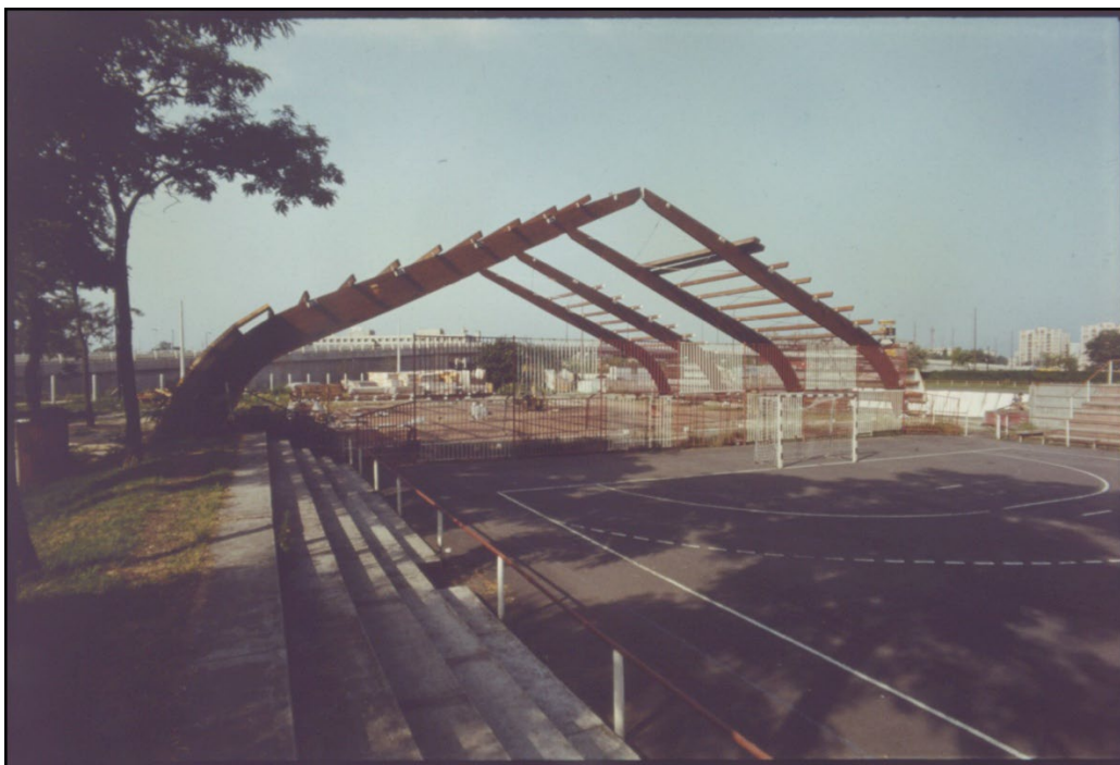
26. kép. Spartacus Teniszcsarnok, Budapest X. Kőér utca. Építész: Sylvester Ádám, statikus: Steinhausz Tibor. Építés közben. Jól látható a háromcsuklós keretes szerkezet. MIEA 22601_0002_0011
