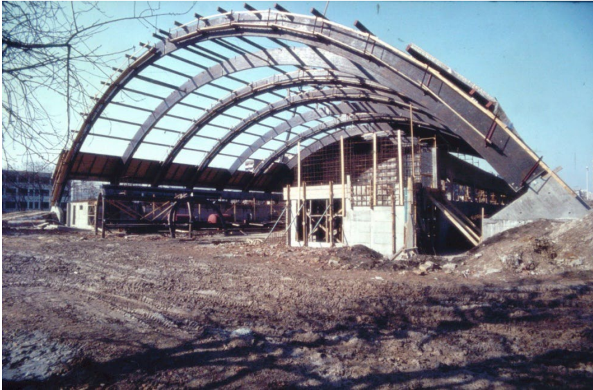
31. kép. Kondorosi úti Uszoda. Építés közben. Jól látható a ragasztott fából készült, hatalmas háromcsuklós keret. MIEA 22602_8_0009
