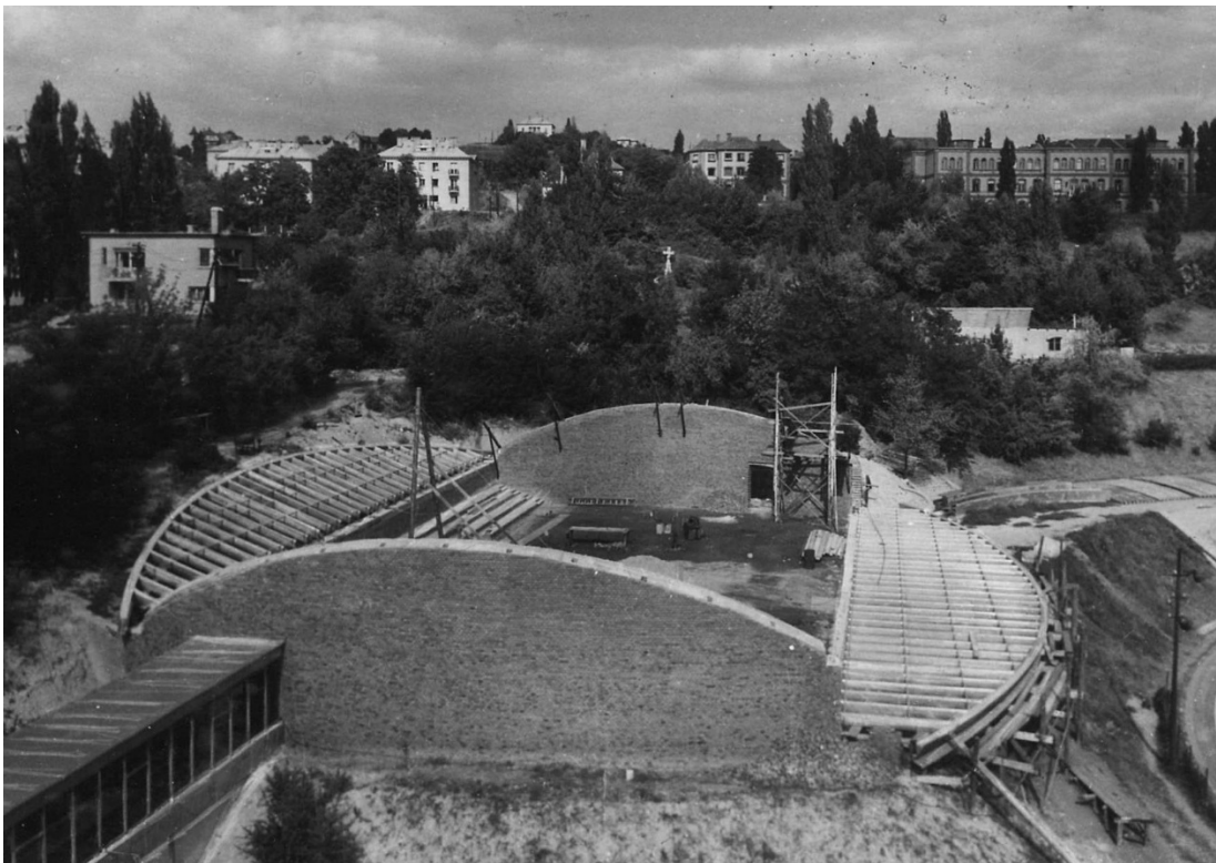
2. kép. Vasas Teniszcsarnok építése. Az íves (önmerevség) és a később felállítandó, a bevilágítást biztosító alumínium üvegfal. MIEA 3911
